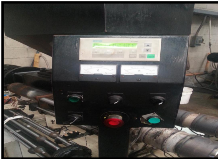
Fotografía: Panel de control
