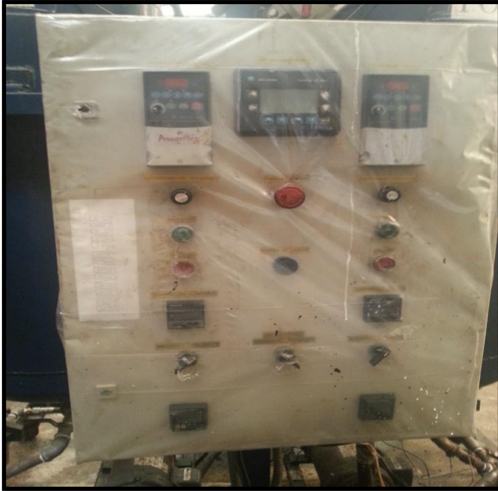
Fotografía: Panel de control
